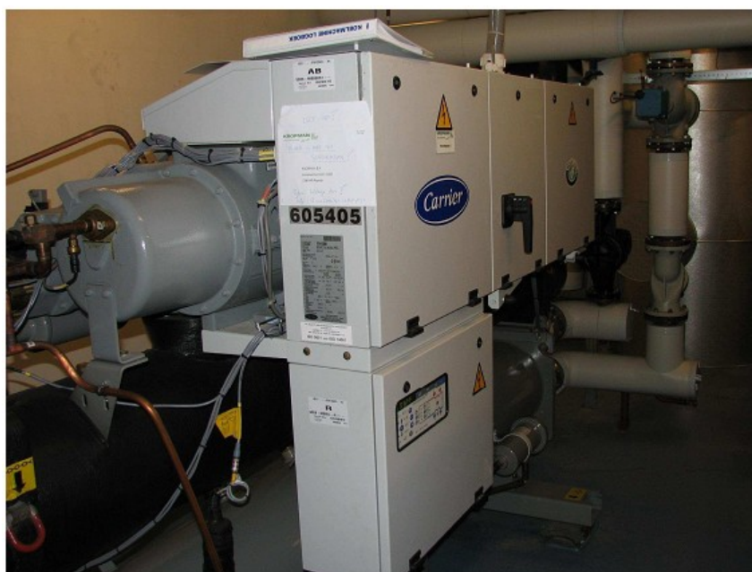
Figure 2 : exemple d'une pompe à chaleur installée à Zuidpoort (Pays-Bas) [4]
