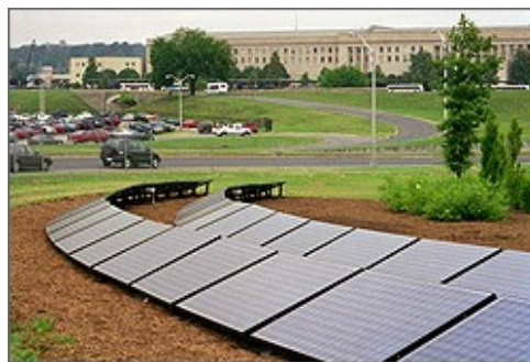
Figure 2b : système photovoltaïque au sol
