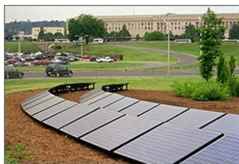
Figure 2b : système photovoltaïque au sol
